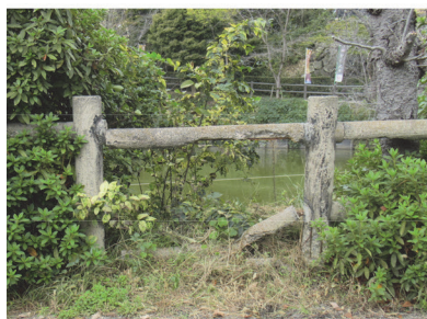
擬木柵（コンクリート） ※破損
