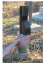
No. 8 : 屋外電源
