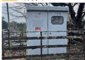
No. 7: キュービクル
