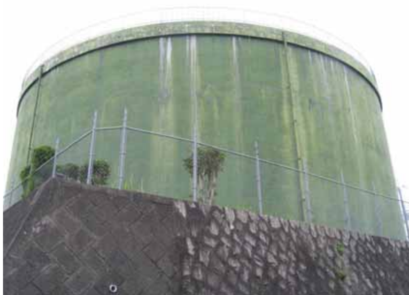
◆ 大阪口配水池 ◆
