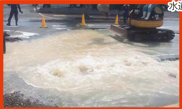
過去の漏水事故（道路埋設管の漏水）写真
