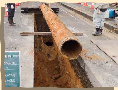
老朽化した水道管が・・・
