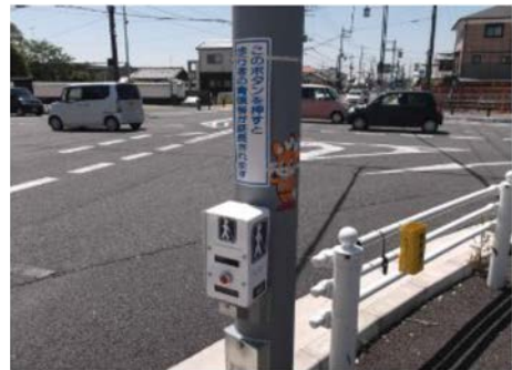
図：青時間延長押しボタンの設置例（郡山北小学校前）
