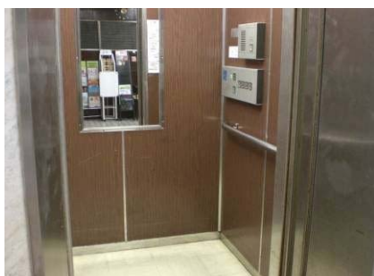
写真 6-27 エレベーター
