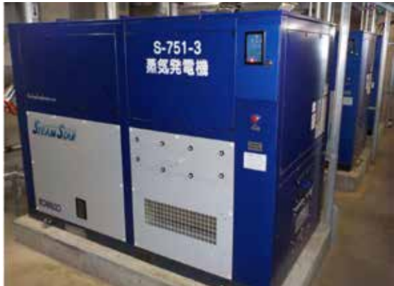
蒸気発電機を導入
